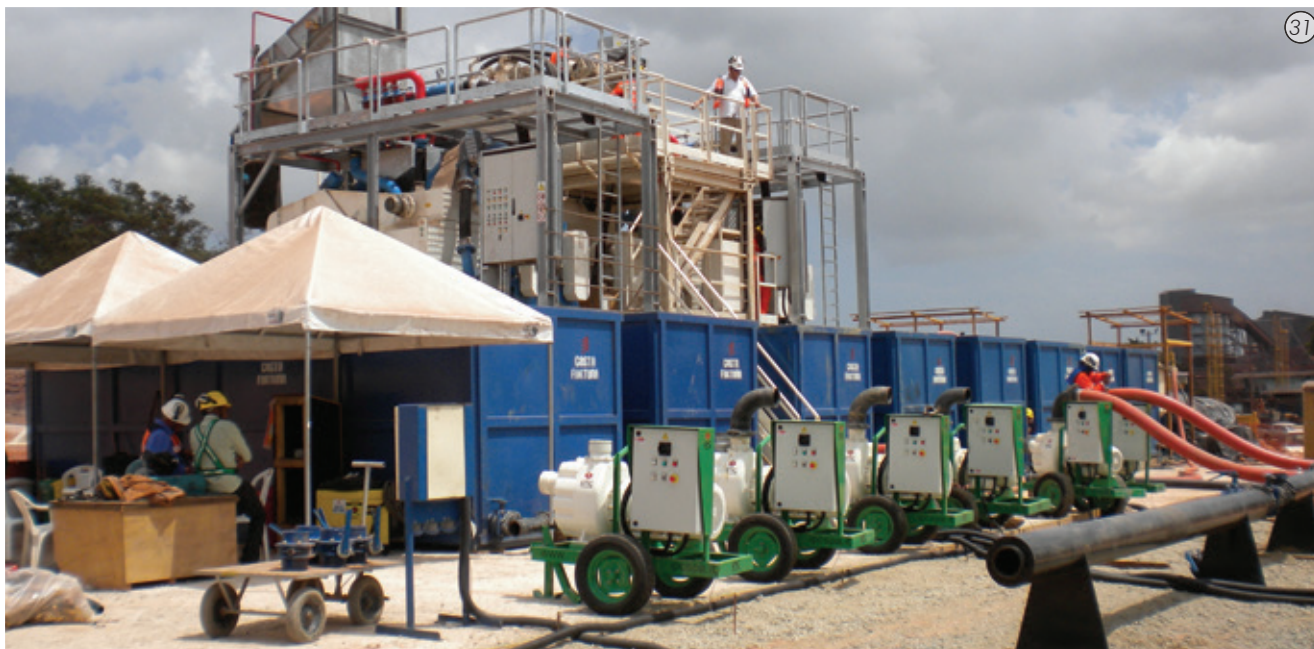
Fig. 31 - Vista da Central de tratamento de fluidos completa para atendimento das duas frentes de serviço simultâneas em São Luiz - MA.
