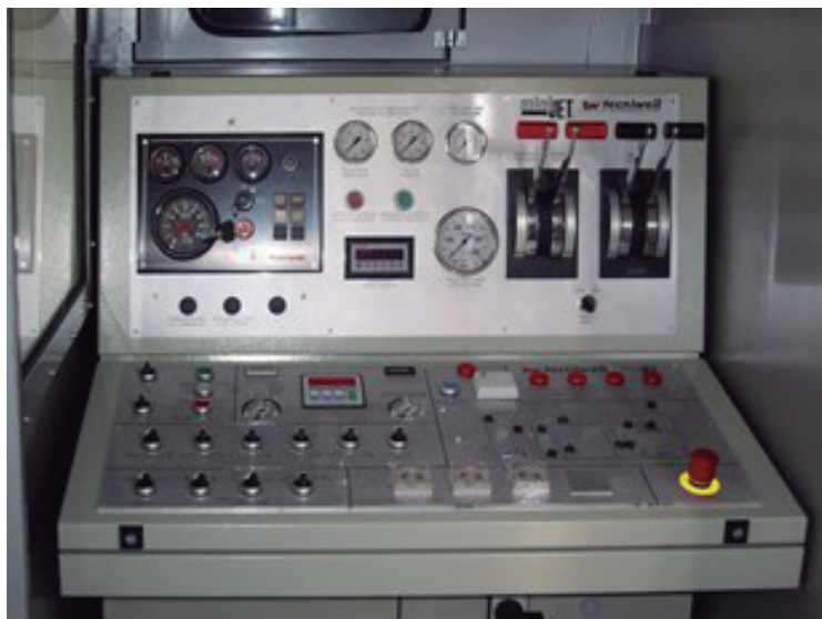
Imagen 23 Panel de control operacional electrónico
